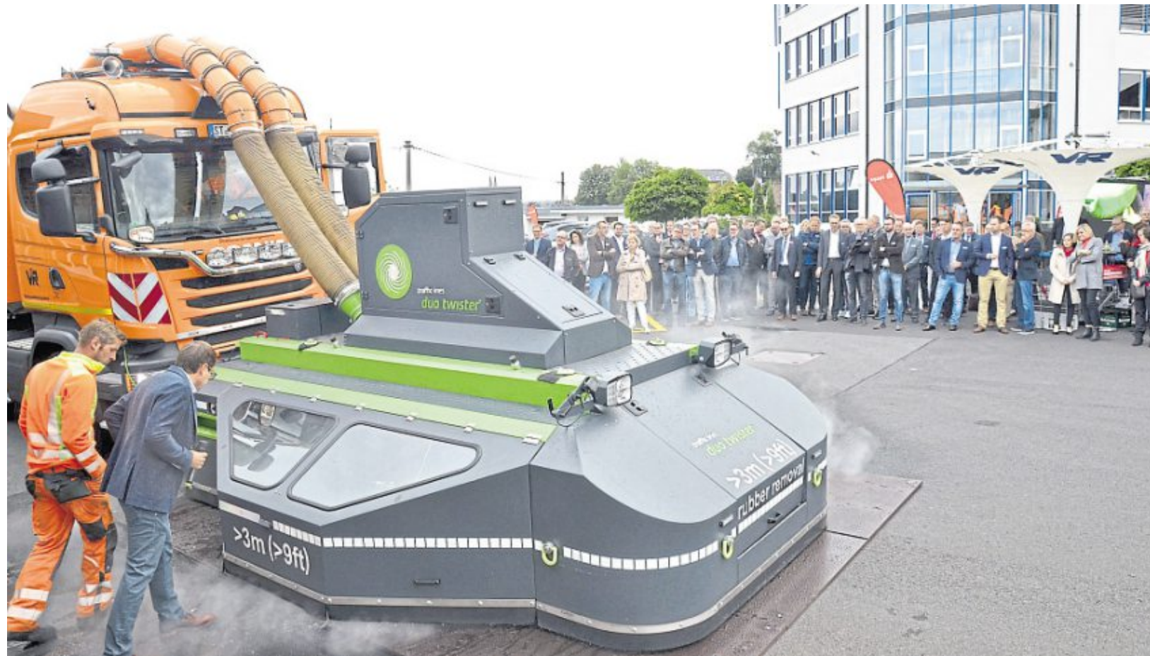
Der sogenannte Ottifant, ein mächtiges, fauchendes, schnaubendes und dampfendes Gespann, das benötigt wird, um alte Markierungen in einem Arbeitsgang restlos von der Fahrbahn zu entfernen, beeindruckte die vielen Teilnehmer am Naspä-Impulszirkel Mittelstand in Montabaur. Foto: Markus Müller
