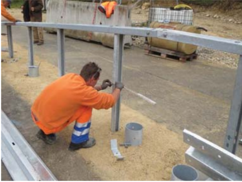
4.16 Anzeichnen und Herstellen der Bohrungen für Defo-Elemente Marking of the holes for deformation-element
